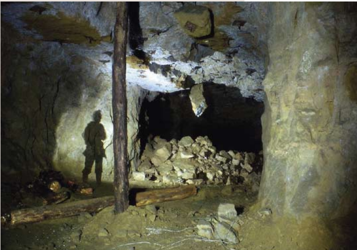
Effondrement du sol et du toit de galeries de mine.
