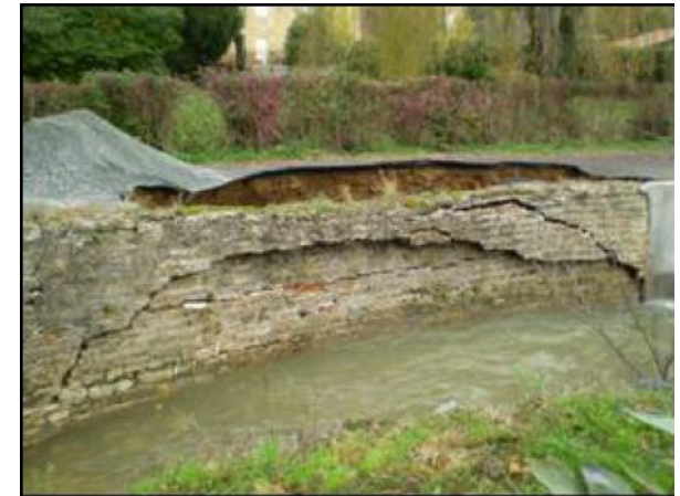
Nizerand – Commune de Denicé Lotissement le Nizerand Dégâts occasionnés par la crue du 02 novembre 2008
