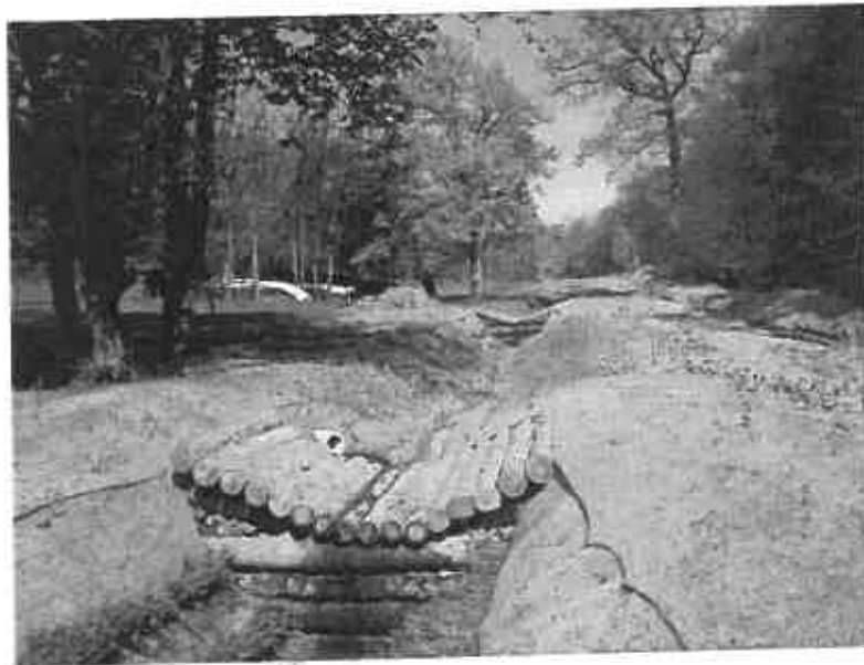
Seuils bois pour caler le profil en long de la Goutte des Verrières à Charbonnières les Bains (avril 2011)
