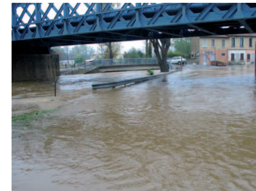
Crue d'avril 2005 rue de Pressensé à Grigny
