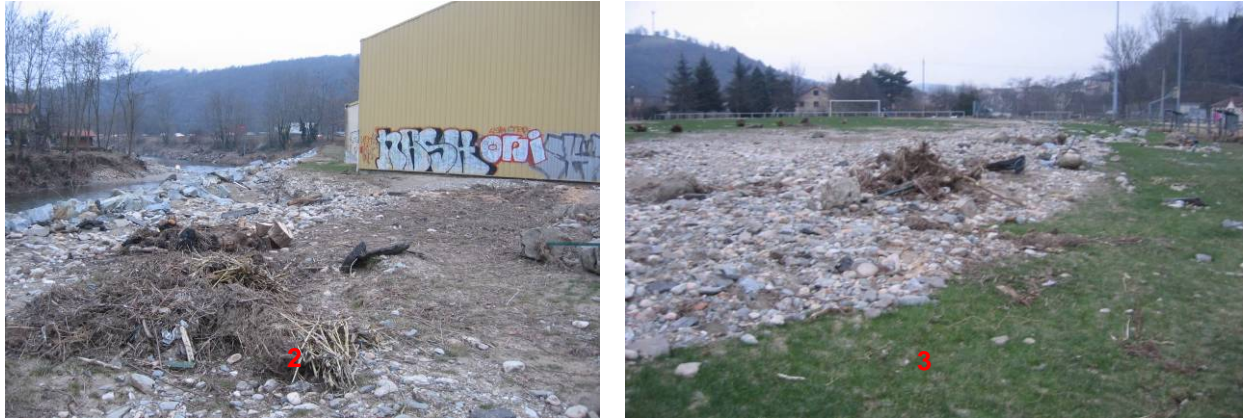
Figure 81 : Gier – Erosion partielle des protections horizontales en place
