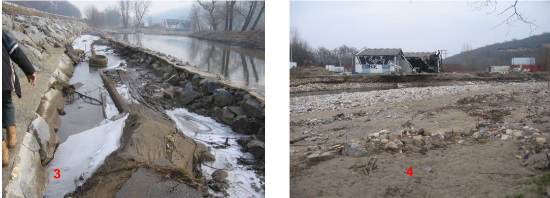
Figure 85 : Gier - Zones d'érosion à l'aval de Saint Romain: le chemin longeant l'autoroute et le bâtiment du garage pour poids lourds
