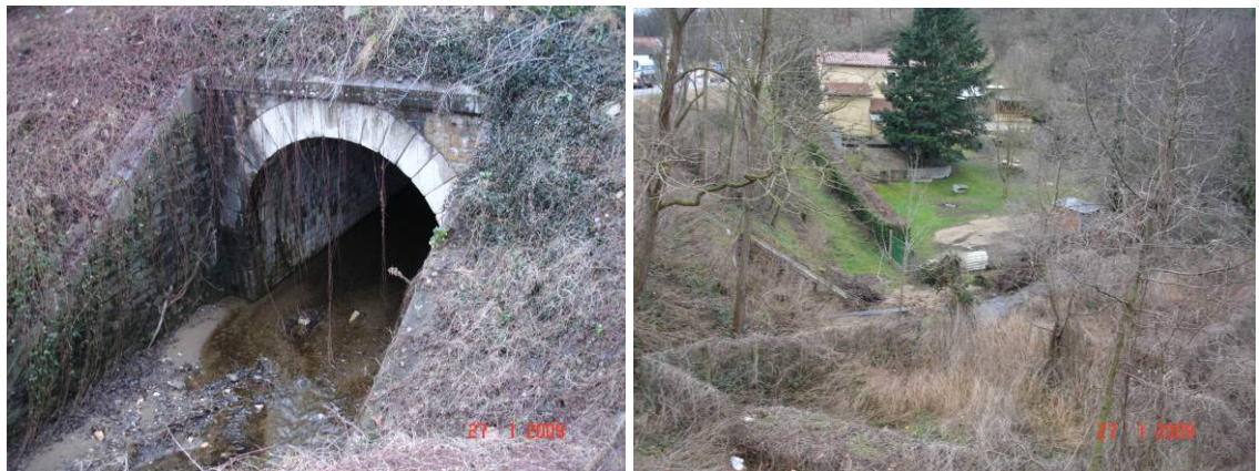
Figure 60 : Alliex - L'ouvrage de la RD 488 (à gauche) et l'habitation située à l'amont (à droite)
