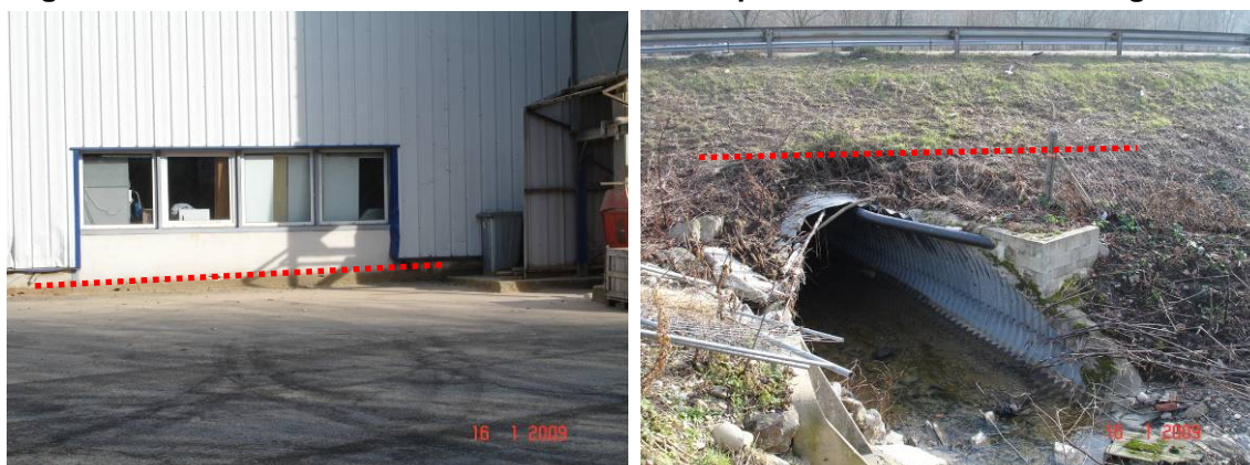
Figure 59 : Niveaux d'eau atteints au droit de l'entreprise et en amont de l'ouvrage limitant
