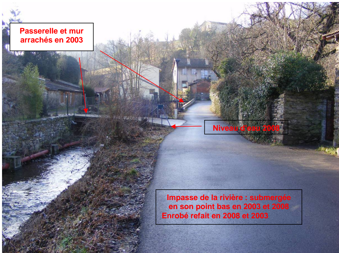
Figure 38 : Le Couzon - Désordres sur l'impasse de la Rivière
