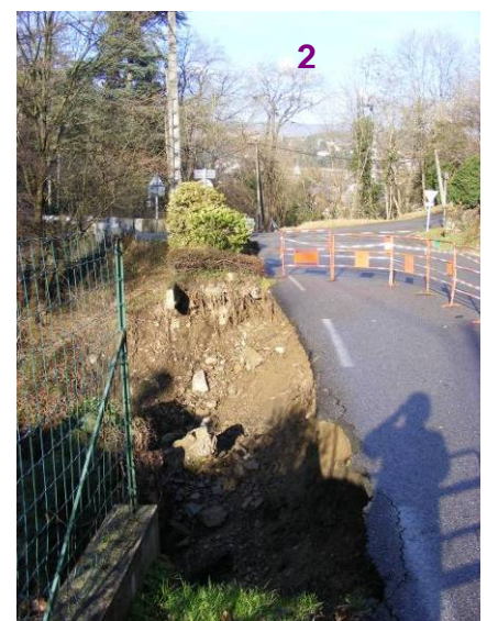
Figure 43 : Le Bourbouillon - Affouillement causé par l'eau en provenance de la grille obstruée
