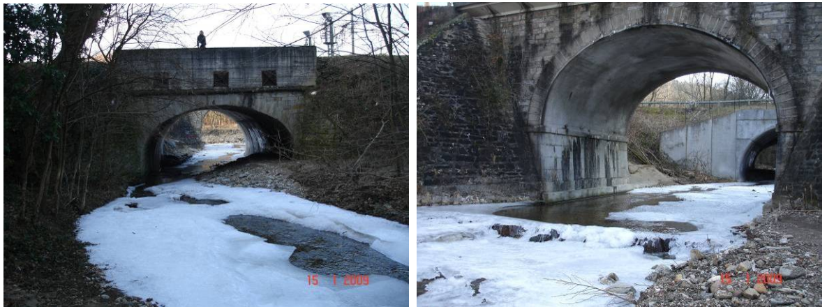
Figure 52 : Le Grand Malval : Ouvrage RD502 (à gauche) et ouvrage SNCF (à droite)
