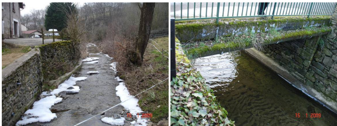
Figure 50 : Le Bozançon dans sa section d'écoulement la plus réduite (à gauche) et l'ouvrage supposé insuffisant (à droite)
